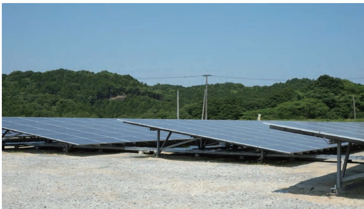
太陽光発電所
